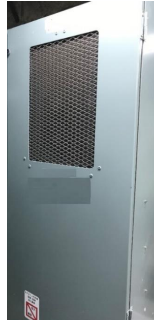
実際に使用した制御盤
