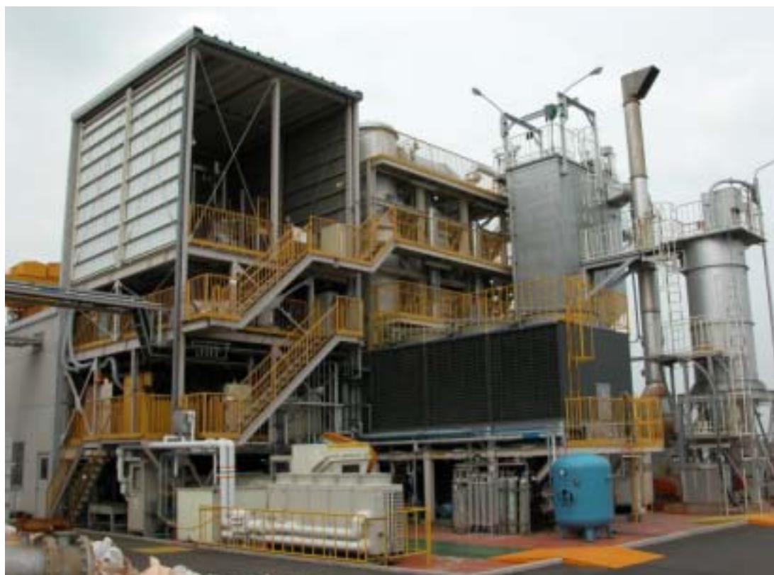
図 2.5.17 トヨタ自動車の ASR サーマルリサイクル実証施設
