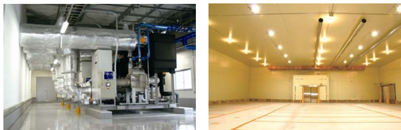
図5 庫内温度-55℃、8000トン超低温冷蔵倉庫
