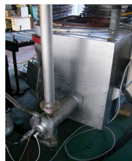
写真4 バーナー取付部
