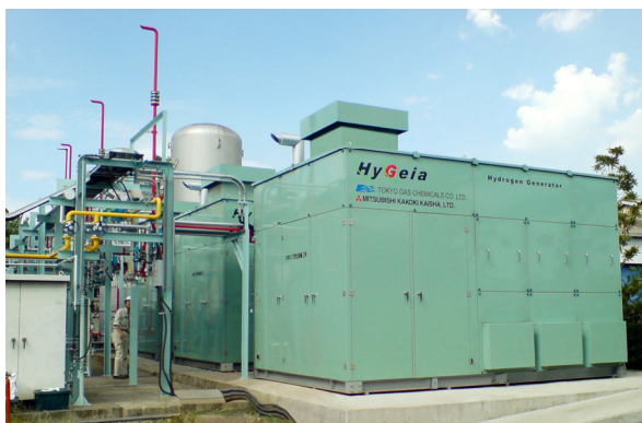
写真1 HyGeia商用機 (水素製造量 100Nm 3 /h機)
